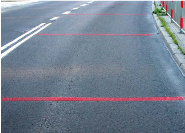
Fot. 9. Linie wibracyjne przed zakrętami w kolorystyce obecnie stosowanej. Czerwone paski słabo kontrastują z kolorem nawierzchni
