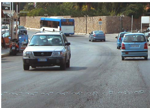
Fot. 5. Oznakowanie przejścia dla pieszych za pomocą specyficznych ćwieków wbitych w jezdnię (Grecja)
