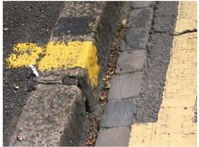
Fot. 6. Żółty, przestrzenny znak na chodniku zakazujący w tym miejscu prac przeładunkowych w godzinach od 8.30 do 18.30 (Londyn)
