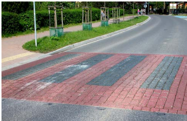
Fot. 4. Próg zwalniający płytowy (U-16b) wyróżniający się kolorem z niezbyt czytelnymi pasami przejścia dla pieszych
